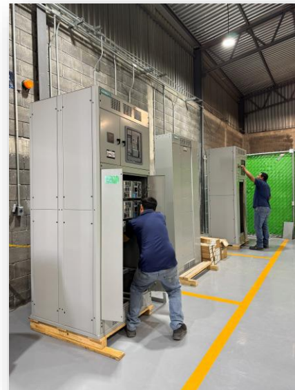
Inspección de tableros
